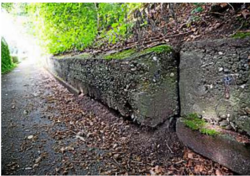
Am Fuß des Damms, der einst schwere Kohlezüge trug, nagt an mehreren Stellen der Zahn der Zeit.
