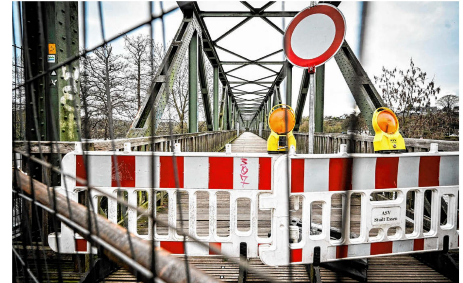
Die ehemalige Eisenbahnbrücke, die Kupferdreh und Heisingen verbindet, ist derzeit gesperrt.
